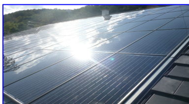
19,5 kWp Indachanlage in Hatzenport
